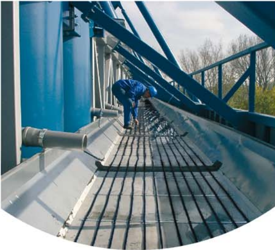
Mocowanie przewodów w korycie dachowym
